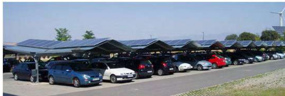
Figura 72 Ejemplo marquesinas solares en aparcamientos 1.
